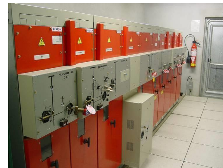
Illustration 11 : Intérieur d'un poste de livraison
